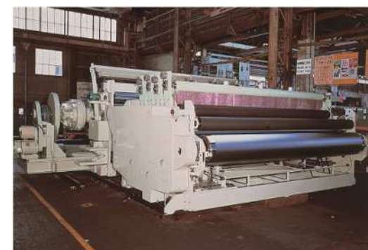
フィルム関連設備
