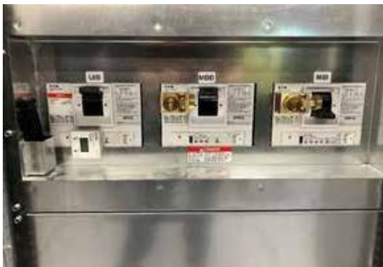
Figure 5. ActivePower社が供給する SKRU付1000A メンテナンスバイパス盤
