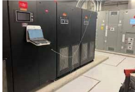
Figure 4. 試運転中の4台のCLEANSOURCE® XT 500ZUPSのうちの1台
