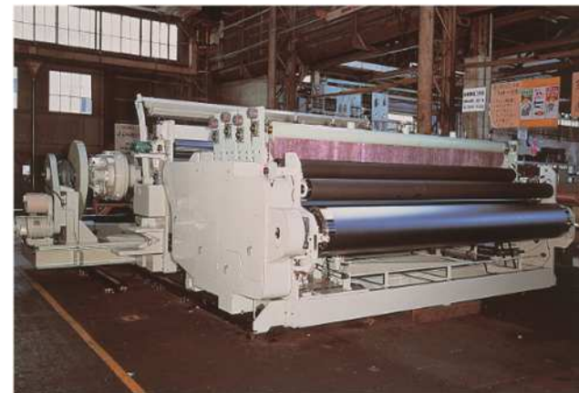
フィルム関連設備
